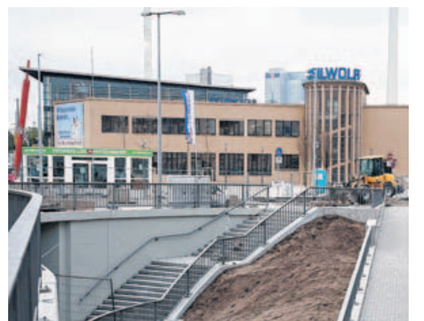
Ziehen sich noch hin: Die Bauarbeiten am Vorplatz des Seilwollf-Centers in Neckarau. Bis Mitte Juni soll aber alles fertig werden. BILD: RITTELMANN
